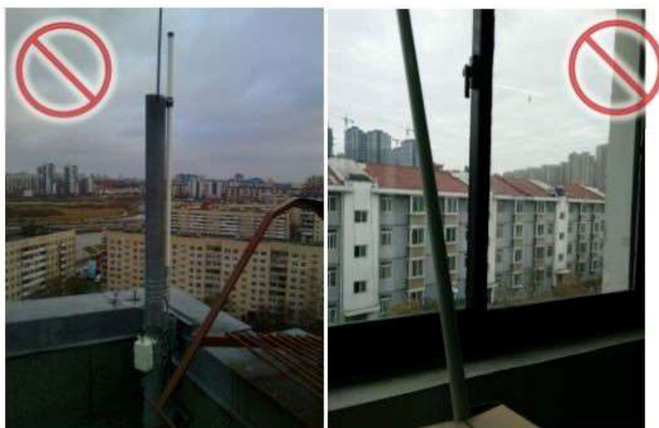
Ошибка! Мачта и молниеотвод закрывают антенну, антенна слишком низко над парапетом (слева); антенна установлена в квартире жилого дома (справа).
